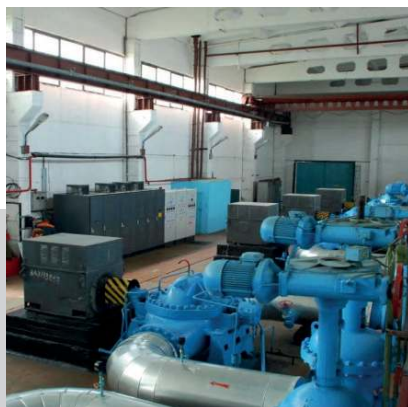
ВНУТРИ ПОМЕЩЕНИЯ НАСОСНОЙ СТАНЦИИ
