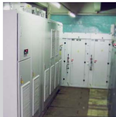
УСТАНОВКА ВНУТРИ ЩИТОВОЙ
