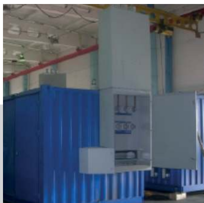
КОНТЕЙНЕРНОЕ, ВНУТРИ ПРОИЗВОДСТВЕННОГО ЦЕХА
